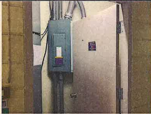
รูปที่ 1 ห้องควบคุมไฟฟ้า ชั้นที่ 3
