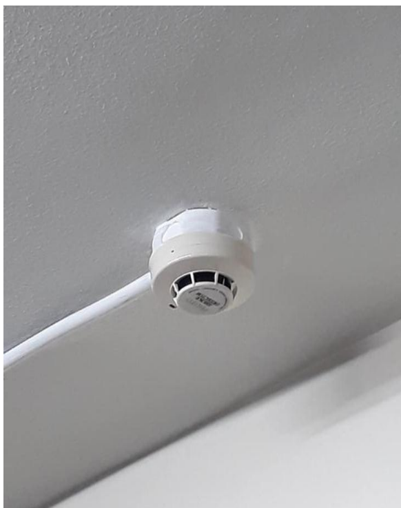
อุปกรณ์ตรวจจับควันติดบนฝ้าเพดาน
