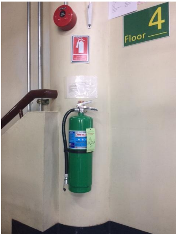
ถังดับเพลิง
