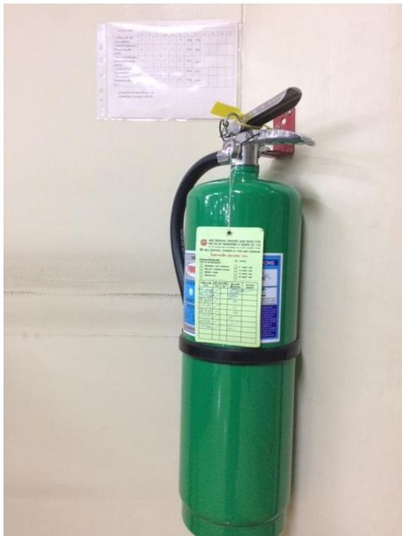
รายการตรวจสอบถังดับเพลิงและผู้รับผิดชอบ
