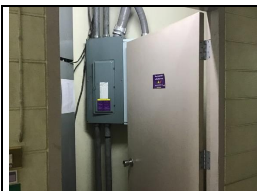
รูปที่ 3 ห้องควบคุมไฟฟ้า ชั้น ที่ 3
